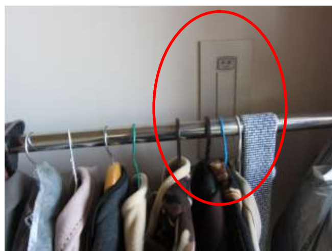
図 4 居室内の排煙窓の操作ボタンの前に物品が置かれた事例(施設 K-T)
