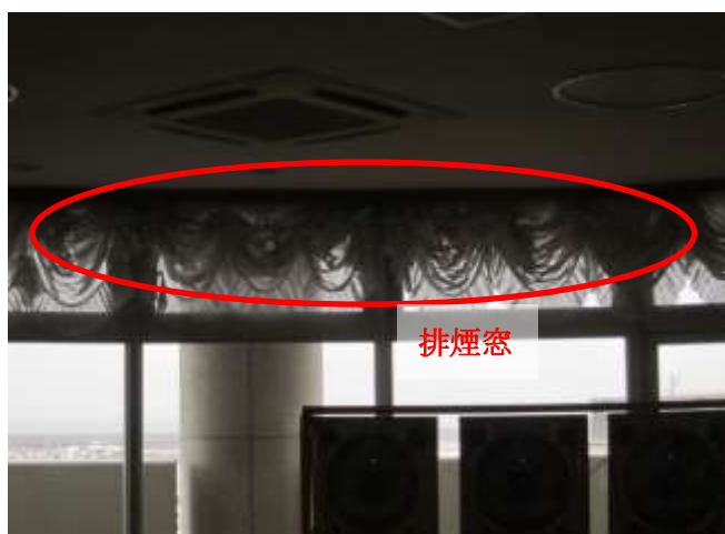
図 3 窓上部の排煙窓にカーテンを設置した事例 (施設 SI-T)
