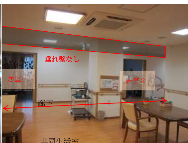
図 2 共同生活室と廊下の間に防煙垂れ壁がない事例（施設 SE-T）
